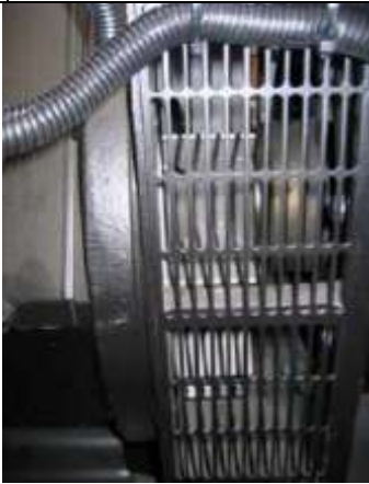
Рис.3 Зона генераторного вентилятора и стыковочных частей
