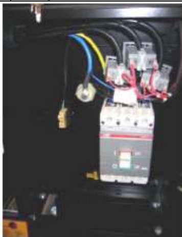
Рис. 1: Открытая электрическая панель
